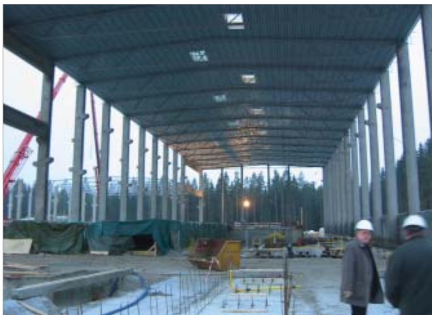
Der Aufbau der Anlage
